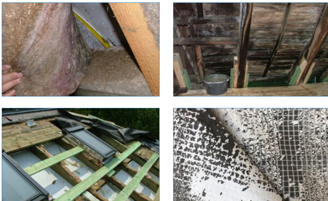
Рис. 2: Примеры повреждений, вызванных неправильным выбором подкровельной мембраны (сверху слева направо: увлажнение и, следовательно, неэффективная теплоизоляция после проникновения воды извне, образование плесени на сплошном настиле, повреждения стропильной конструкции из-за воздействия влаги, старение функционального слоя мембраны)
