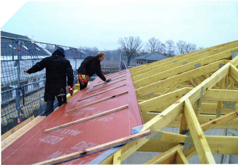
▲ Unterspannung der Klasse 3 beim Neubau eines flach geneigten Dachs. Wird hier später eine Zwischensparrendämmung eingebaut, wird die nun aufliegende Bahn zur Unterdeckung
